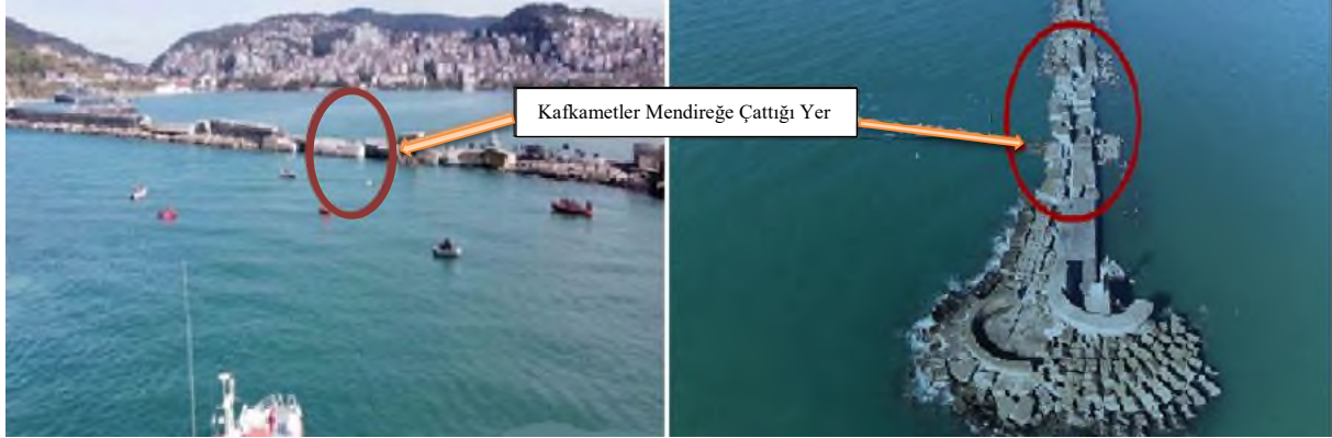
Resim 10 Kuzey Mendirek Hasar Sonrası
